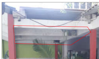
Foto 7 - Trecho para recompor o reboco
