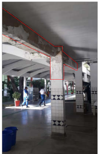
Foto 3 - Trecho a recompor o reboco emassar e pintar
