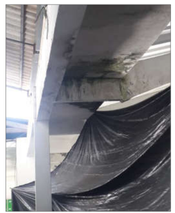
Foto 5 - Trecho ao longo de toda a calha para efetuar limpeza
